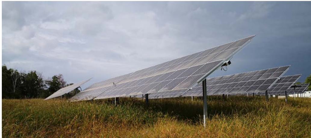
▲ Die alte und die neue repowerte Anlage in Lüptitz mit Weißkleeanbau
