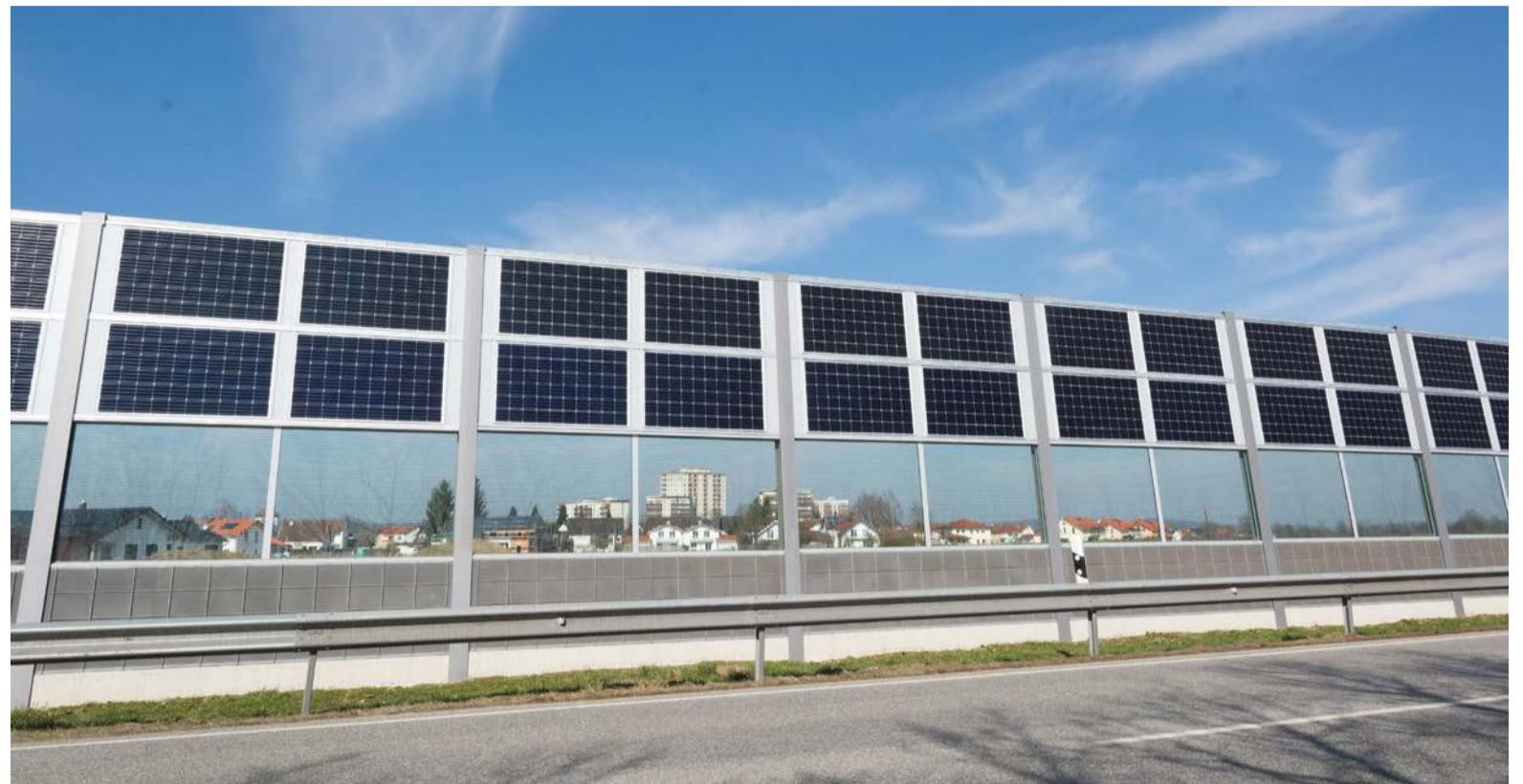
▲ Neuartige Lärmschutzwand mit Photovoltaik-Modulen und transparenten Elementen der EGIS eG in Neuötting
